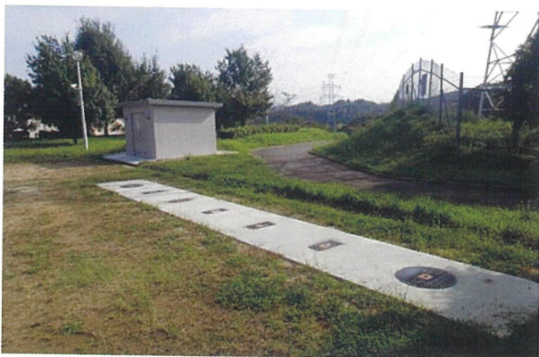
写真7 マンホールトイレ
