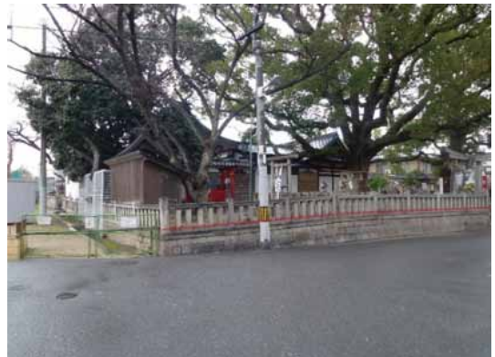
写真4 鷹合神社の石垣の不等沈下
