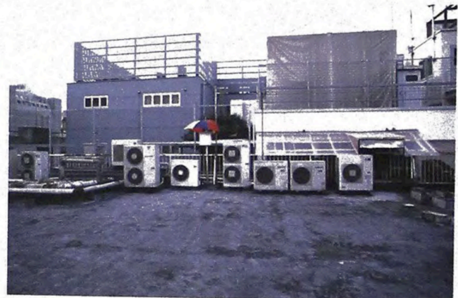
資料写真 3.3.1-3 新日本三ツ寺ビル 屋上の空調室外機
