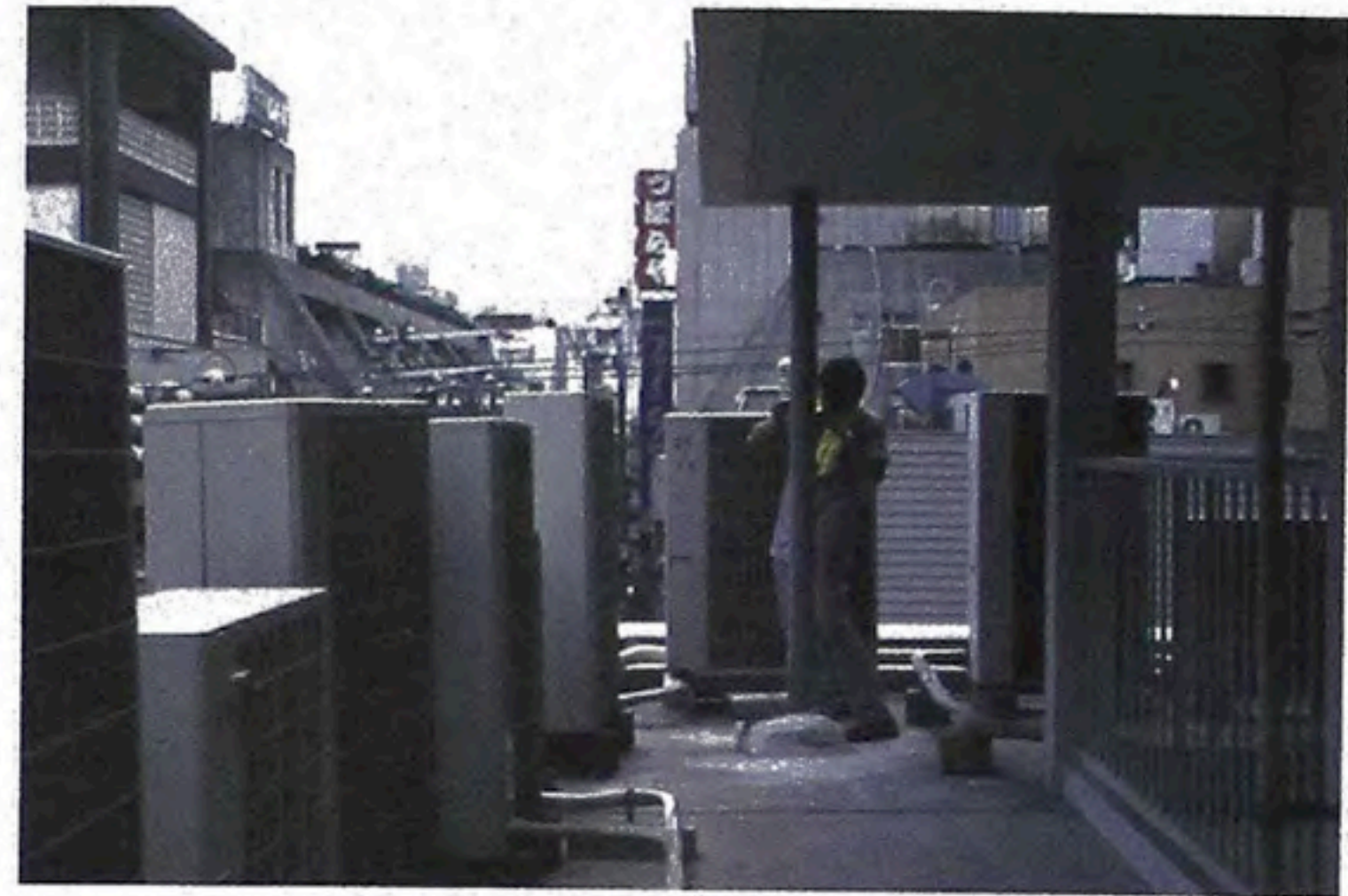
資料写真 3.3.1-2 新日本三ツ寺ビル 4階ベランダの空調室外機 入居するスナック、バーなど各店舗が設置
