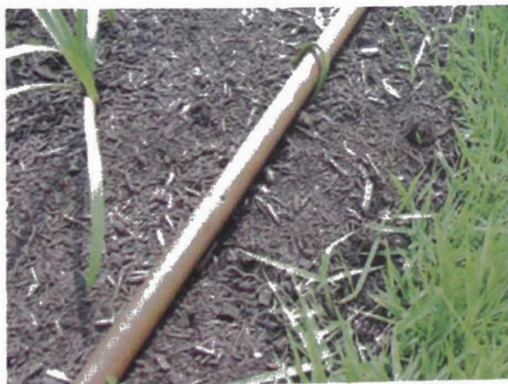
資料写真 4.2.2-5 本庁舎屋上緑化施設 灌水用パイプ(2004年6月)
