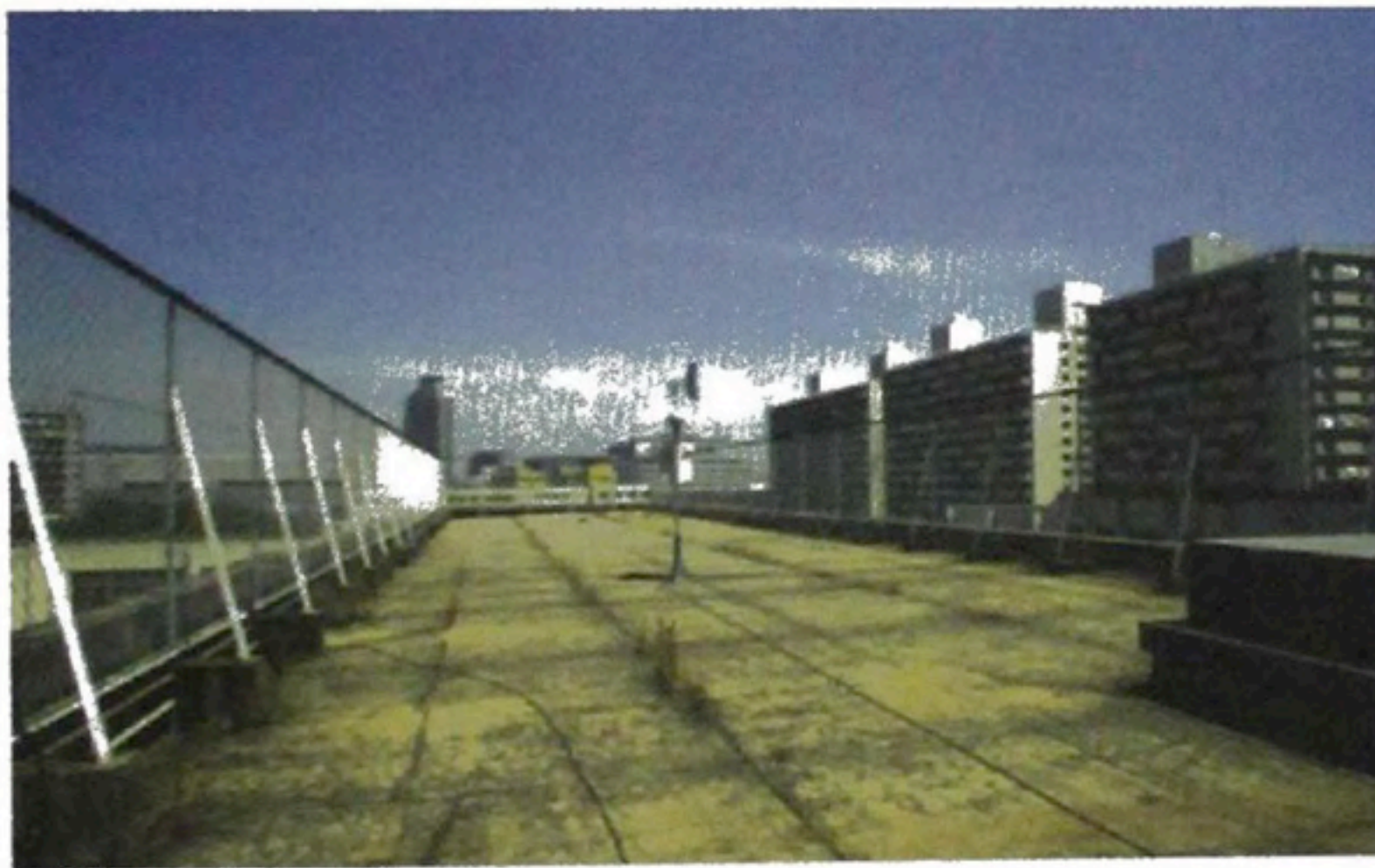
資料写真 3.2.2-2 港湾域 南港光小学校屋上 (大阪市住之江区南港中)
