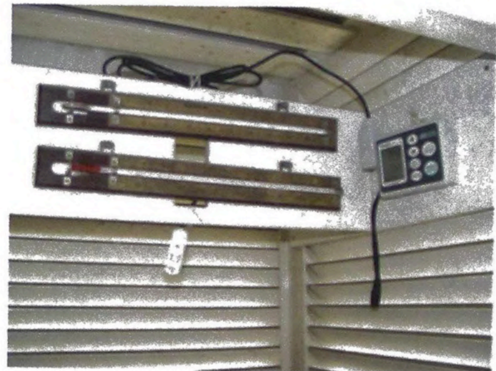
資料写真 3.2.1-4 百葉箱内部 中央にセンサー、 右にデータロガーを設置。 既設の水銀温度計は使用せず
