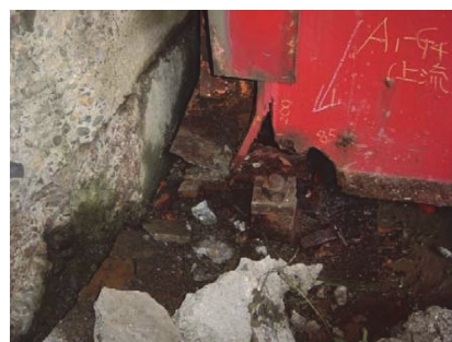
写真-4.1.2 腐食で損傷した状況 2)
