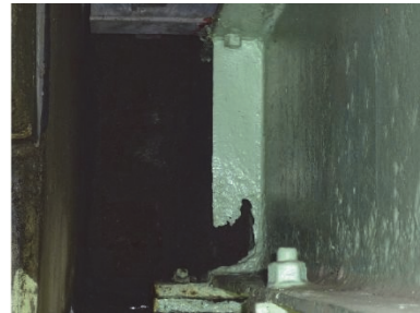
写真-1.1.2 腐食の状況
