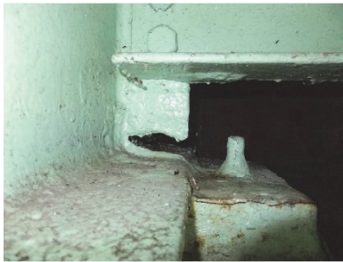
写真-1.1.1 腐食の状況
