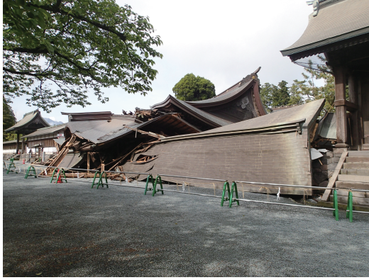
図2 阿蘇神社楼門の倒壊状況
