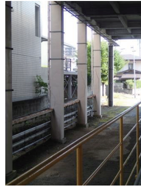
写真 12 熊本電鉄藤崎宮駅 駅舎の柱に見られるクラック
