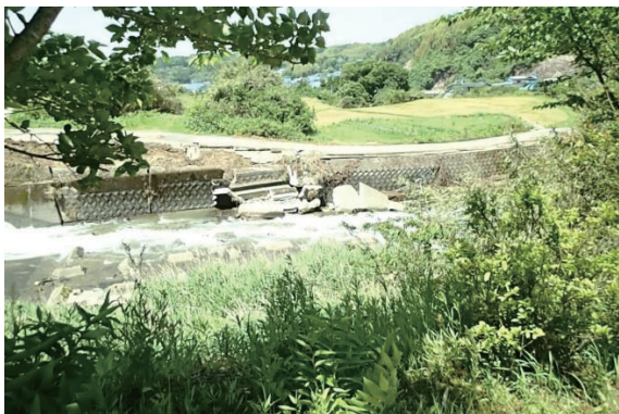
写真19 益城町木山川にそそぐ支川の護岸崩壊の様子
