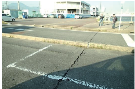
写真 32 熊本港内における水平変位
