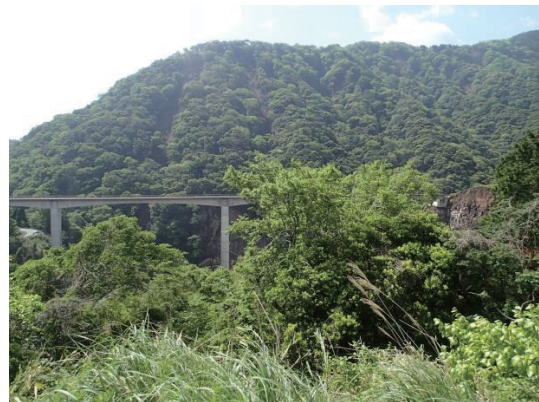
写真 14 阿蘇長陽大橋の橋台部分の崩落（右端）
