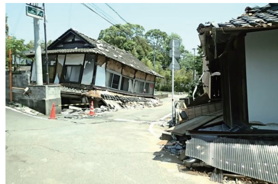
写真 28 益城町寺迫の住宅被害
