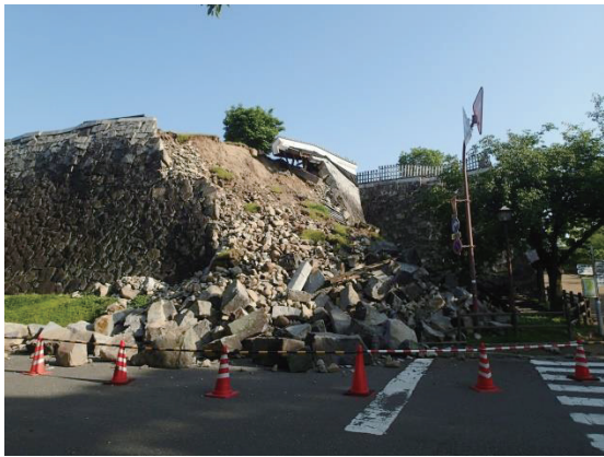
写真5 熊本城二の丸付近 御客方櫓跡近くの石垣崩壊
