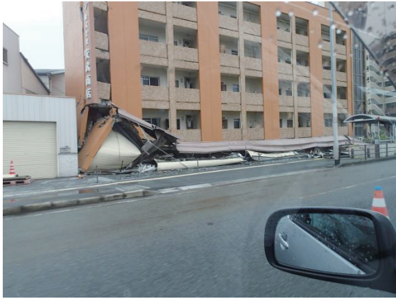
写真1 国道57号線（通称東バイパス）沿いの建物被害
