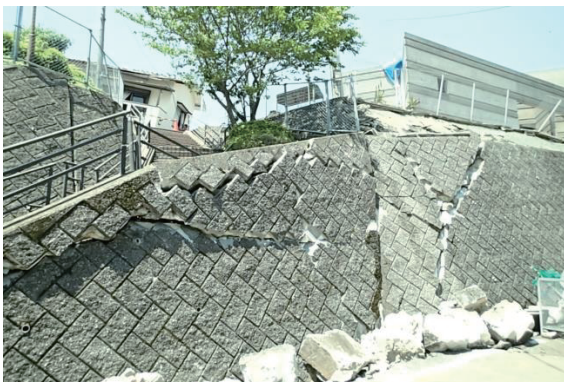
写真 27 益城町文化会館南側の擁壁被害
