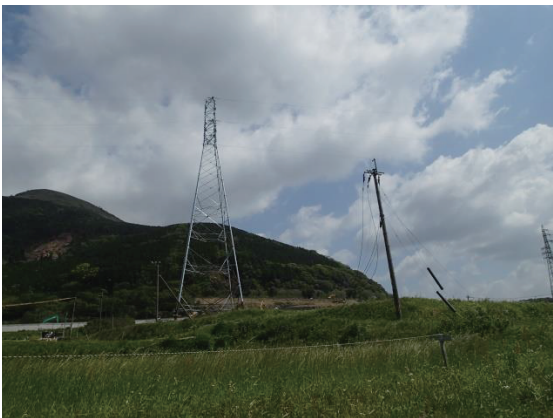
写真 13 阿蘇郡南阿蘇村立野付近にある破断した鉄塔
