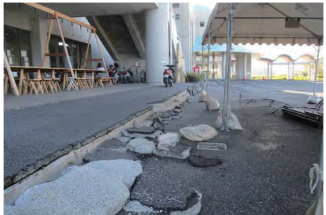
写真6 液状化による建物の抜け上がり（益城町総合体育館）
