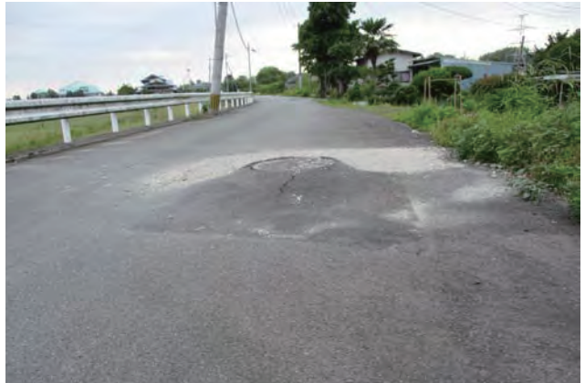
写真8 液状化によるマンホールの浮上（益城町秋津川）
