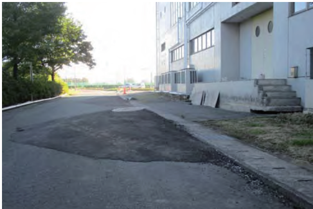
写真7 液状化によるマンホールの浮上（益城町総合体育館）
