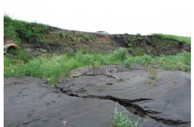
写真10 液状化による河川堤防の噴砂（阿蘇市）
