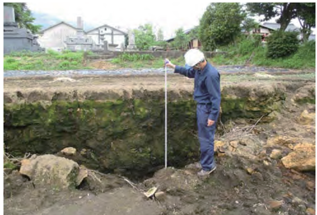
写真 29 阿蘇市狩尾の北側陥没変形（鉛直ずれ約 1.5m）
