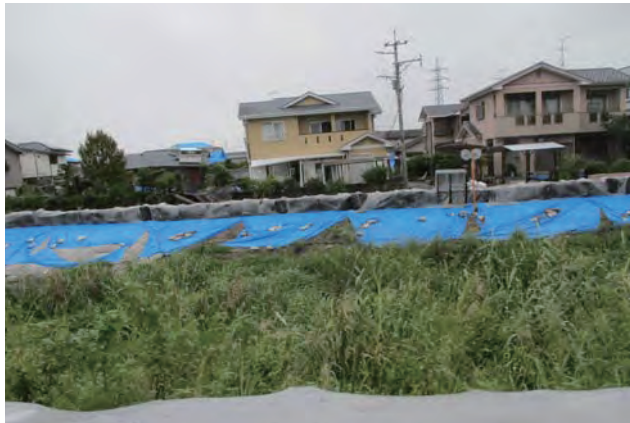
写真5 液状化による堤防の沈下（益城町秋津川沿い）
