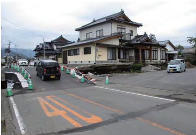
写真 28 阿蘇市狩尾の北側陥没変形（鉛直ずれ約 1.5m）
