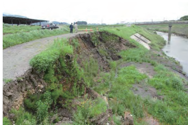
写真9 液状化による河川堤防の崩壊（阿蘇市）
