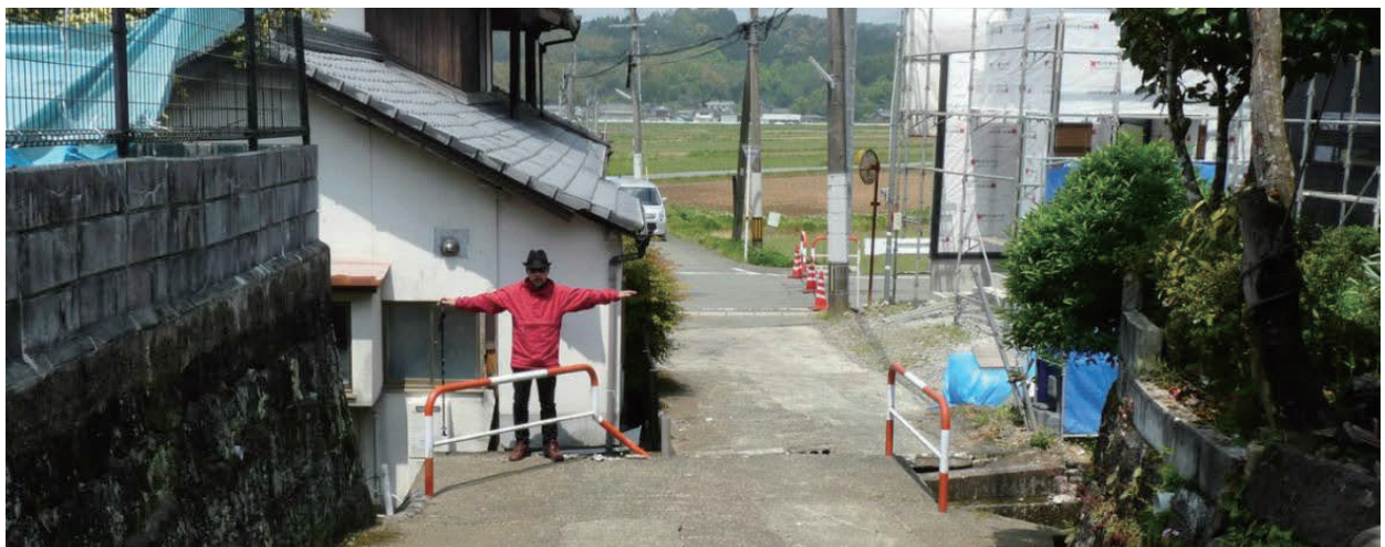
図4 地表地震断層で右ずれ変位した道路と断層に近接した民家
