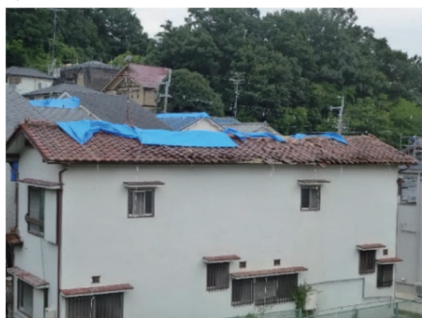
図2 被害有に区分される調査対象の 二階建て瓦葺き木造建物の個別住宅
