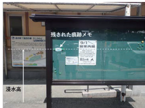
写真-4 道の駅「ひじかわ」の浸水痕跡
