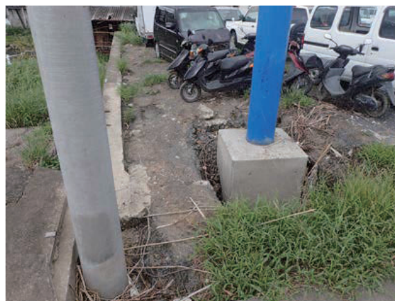
写真-11 河道に近接する地点の大型看板の基部に生じていた洗堀被害
