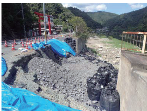
写真-5 鹿野川大橋橋台部分（左岸）の破壊
