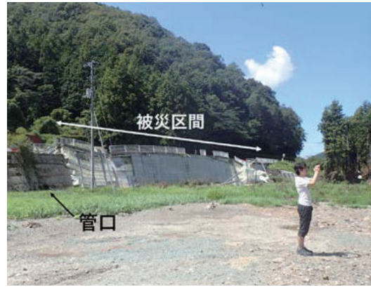
写真-2 高水敷側より道路擁壁被災状況
