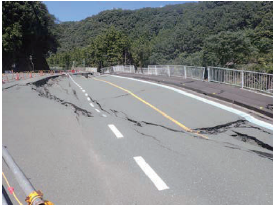
写真-1 国道 197 号線 道路破壊
