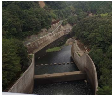
(b) 通路南側より被災部拡大
