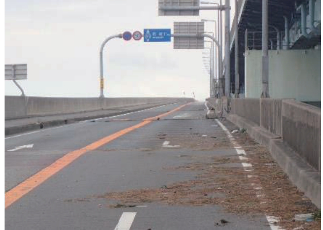
写真-9 県道 573 号線の床版ずれによる通行止め
