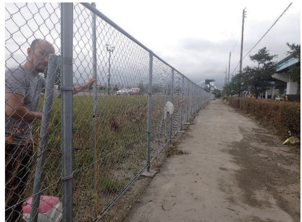
写真-11 甲子園浜南部 県道 573 号線に面したフェンスに残る浸水痕跡
