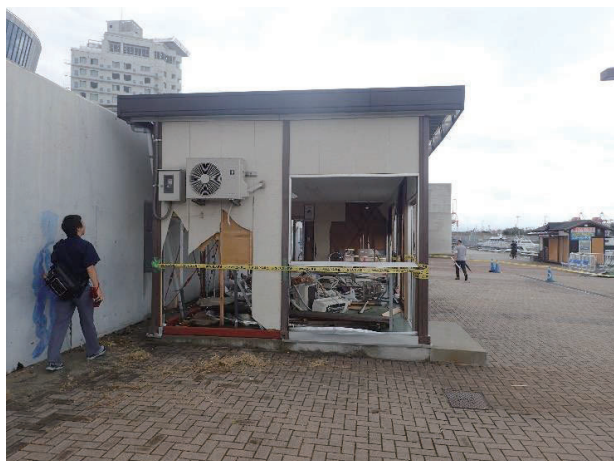
写真-1 天保山西岸壁船客待合所の被災
