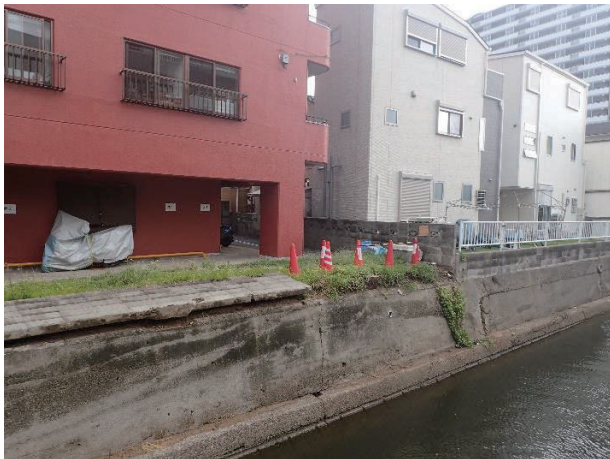
写真-16 高橋川沿いのブロック塀の倒壊
