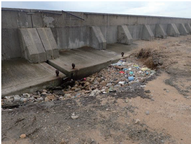
写真-6 夢洲護岸背部の吸出しによる被災
