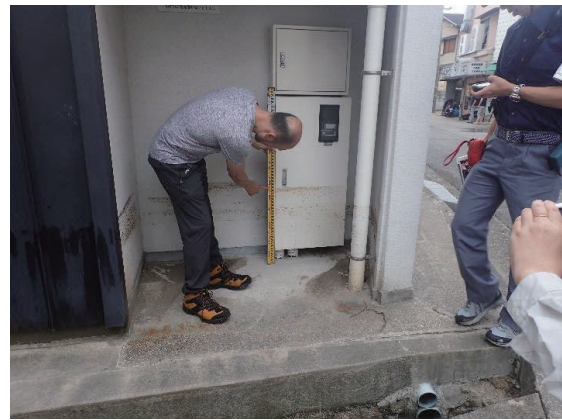
写真-15 神戸市東灘区深江北町の浸水痕跡
