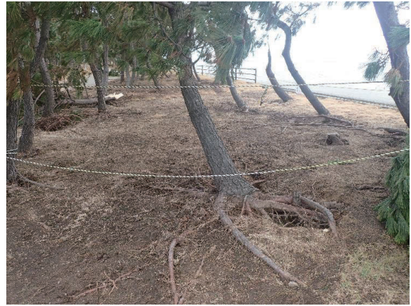
写真-13 南芦屋浜ベランダの植生に生じた洗堀
