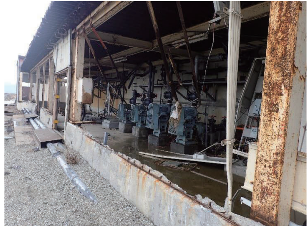
写真-7 内水ポンド施設の被災
