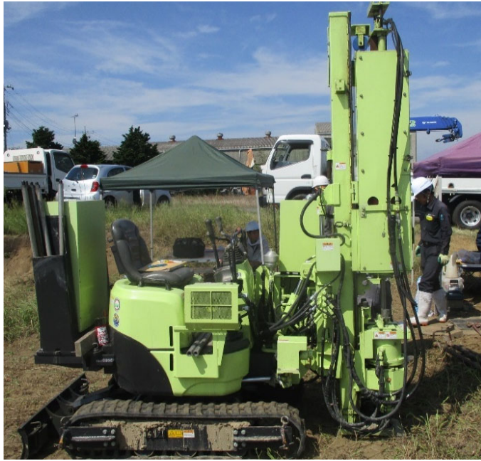
(1) H-DCPT 機の全体像
